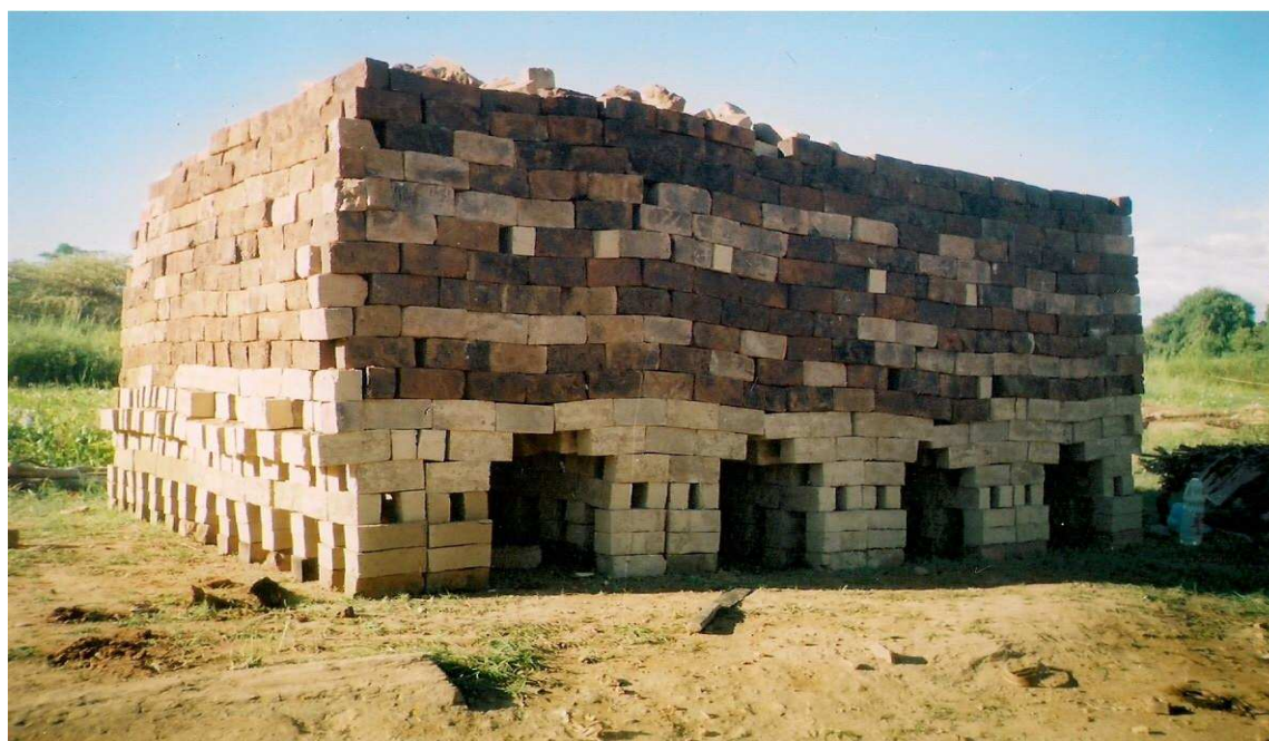
Photo N°6 La four de brique à Ambanja
