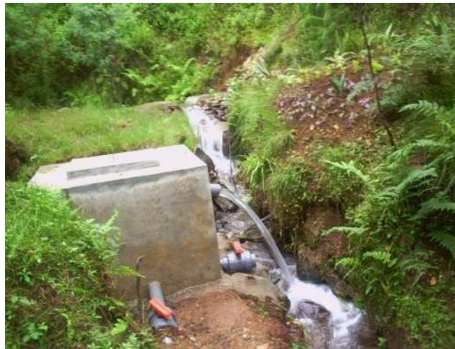
Photo 3 : Chambre de mise en charge
