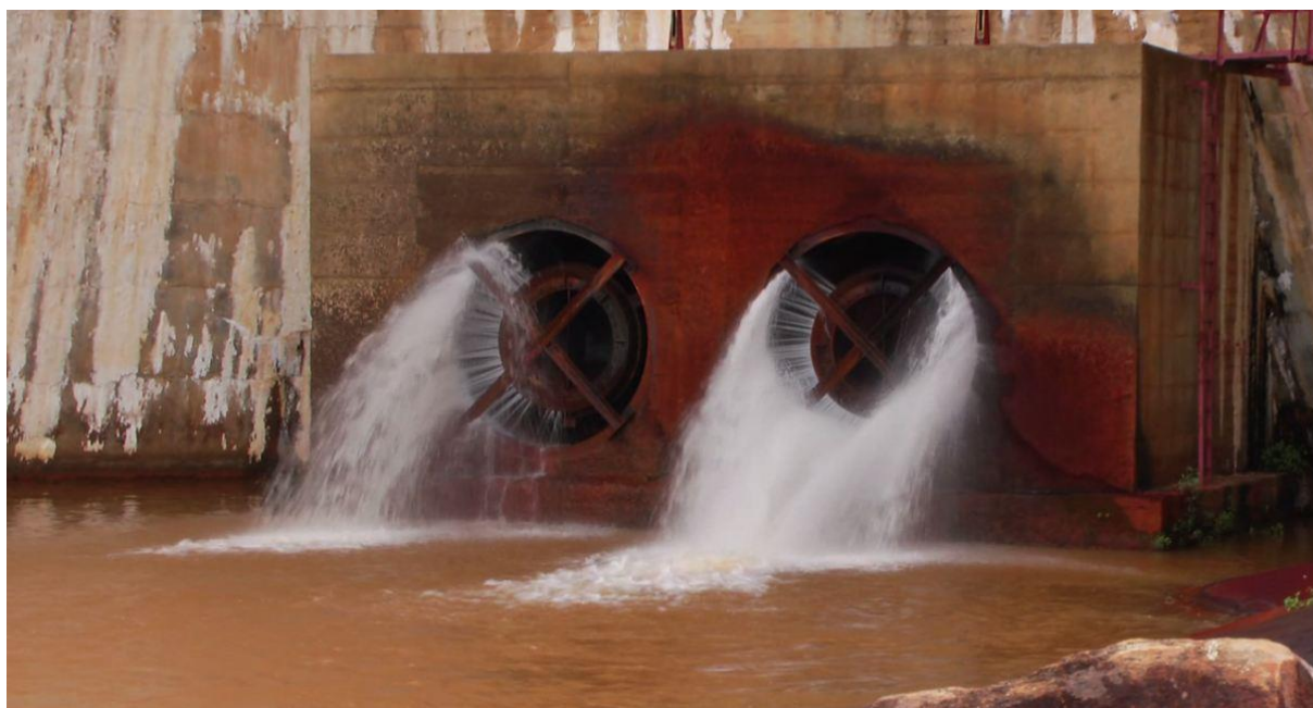
Figure des deux vannes de barrage de Varahina
